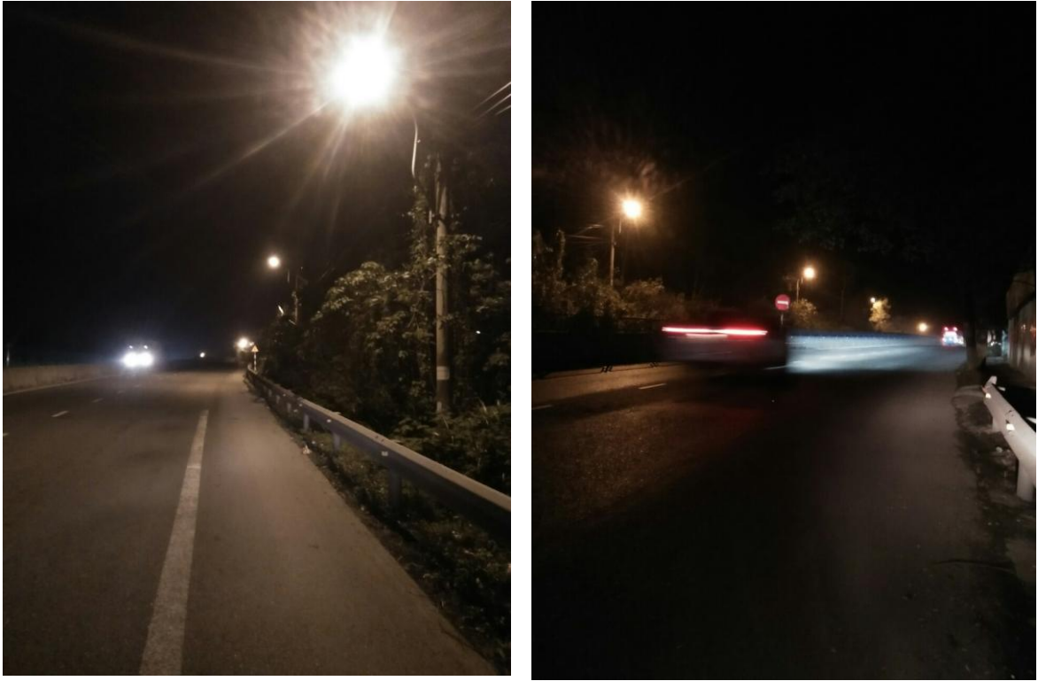
Hình ảnh hệ thống điện chiếu sáng Mũi Né sau khi hoàn thành sửa chữa
